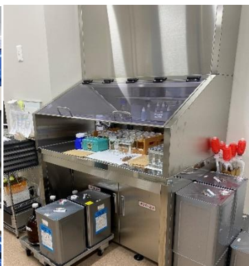
▲換気装置（標本作製室）
