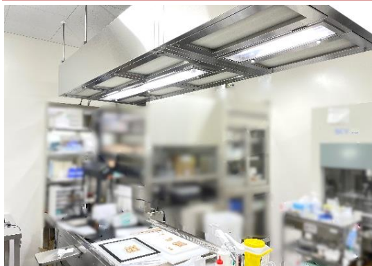
▲切り出し室内の換気装置
